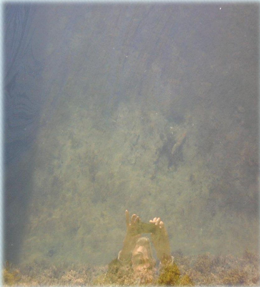
Vue du fond par transparence - Avant traitement Talon béton recouvert par les sédiments
